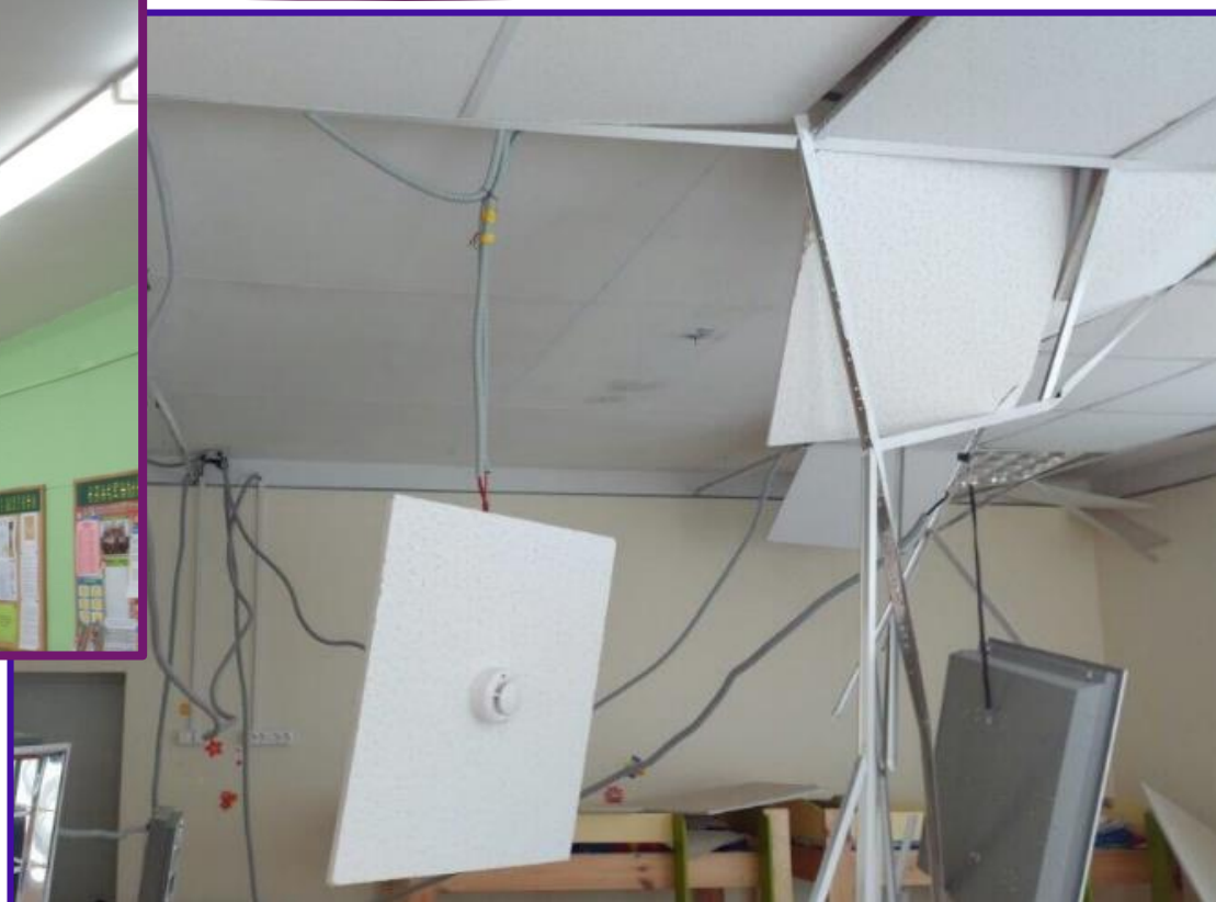
Повреждение подвесного потолка
