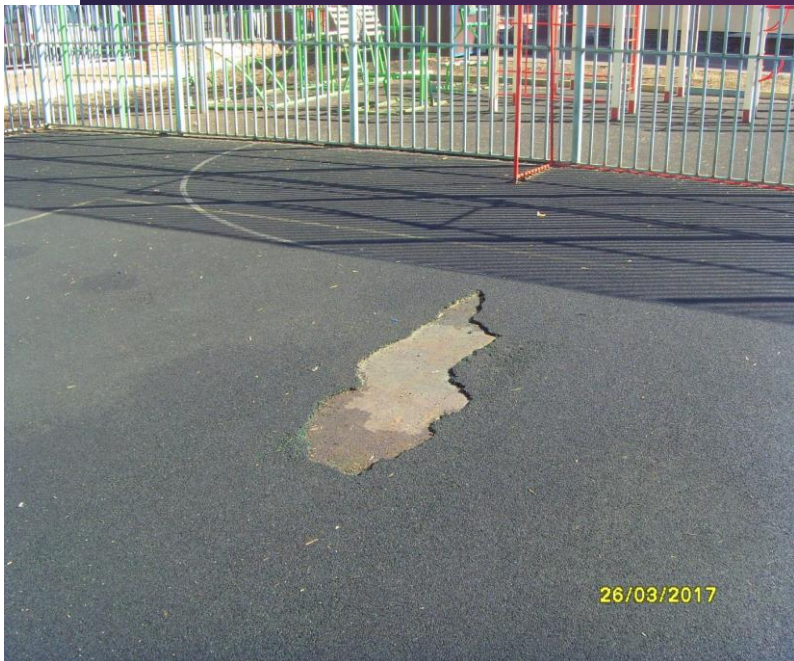
Повреждение покрытия спортивной площадки
